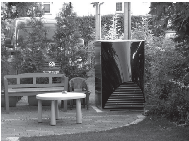
Wärmepumpe mit Außenaufstellung
